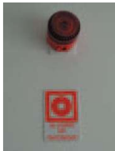
Figura 36 – Detalhe de sirene
