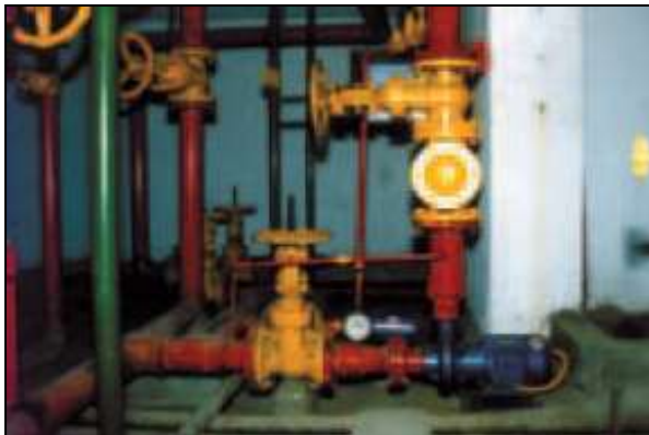
Figura 43 – Bomba de incêndio e acessórios hidráulicos
